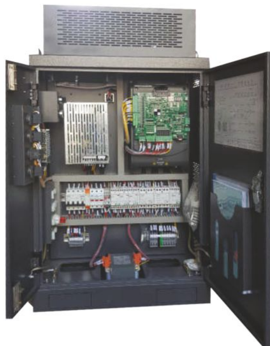
TỦ ĐIỆN FUJI - MALAYSIA
