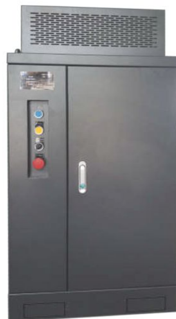
TỦ ĐIỆN FUJI - MALAYSIA
