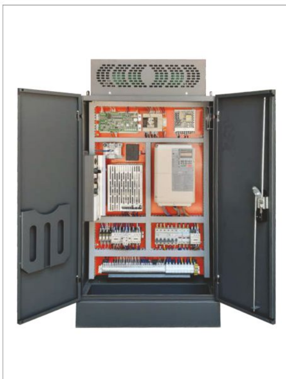
TỦ ĐIỆN PLC FX3G + VVVF YASKAWA
