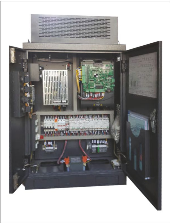
TỦ ĐIỆN FUJI - MALAYSIA
